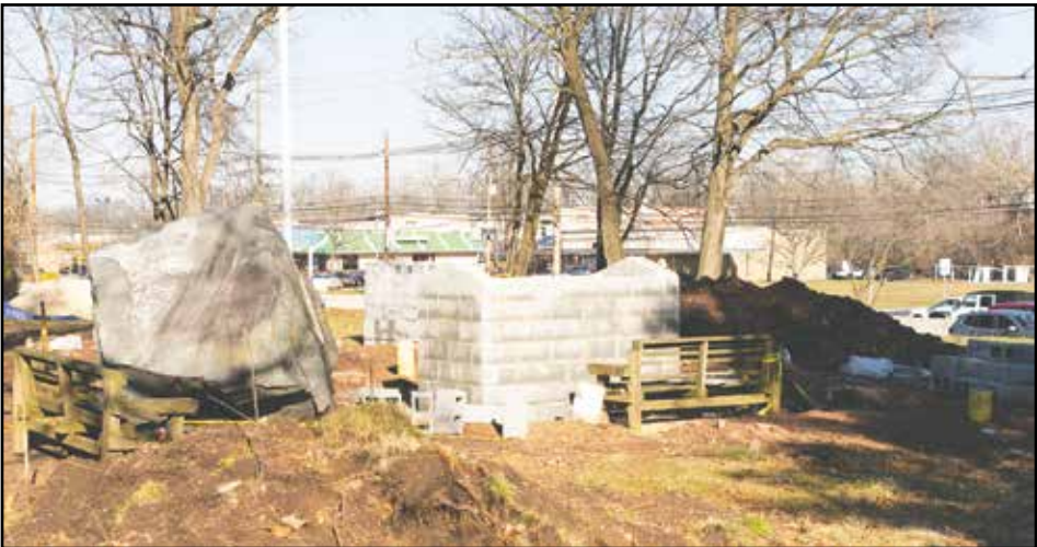
TRABAJO DETENIDO – El municipio ha emitido una orden de suspensión de trabajos en la remodelación del Parque Conmemorativo Guglielmo Marconi.
